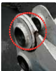
プレートピンボス 周りの亀裂
