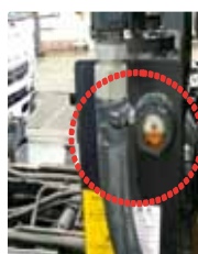
作動油タンク内 オイル汚れ
