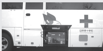
安定した稼働を求められる発電機
