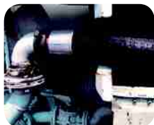
排出ホース劣化
