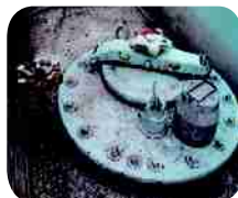
底弁シャフト・ハッチ錆
